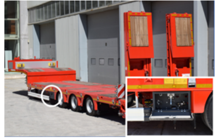
Standort des Schaltschranks im Tiefladerfahrzeug
