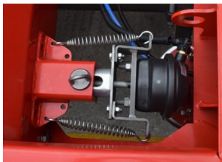
Stan otwarcia zaworu pneumatycznego
