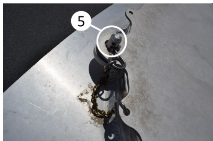
Pokrywa uszczelniająca włazu
