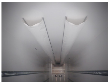
Kanał wentylacyjny typu rurowego
